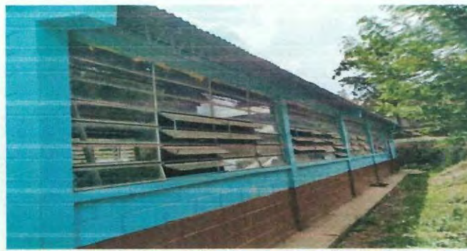
Foto 2: Se observa en area de ventaneria piezas de vidrios en mal estado y/o faltante.
